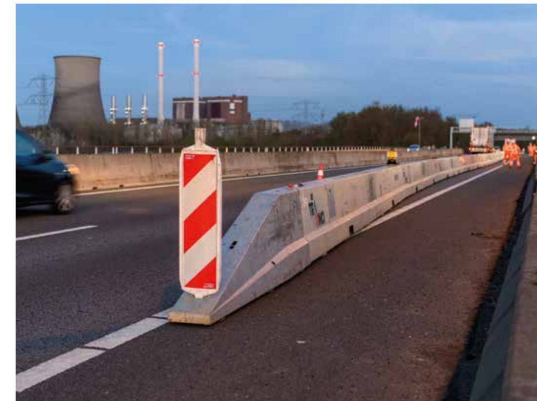
We zetten de eerste Go-Barry in bij de werkzaamheden aan de A2. Foto: © Studio Retouched
